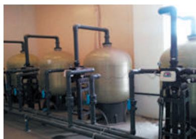
Станция обезжелезивания хозяйственно-питьевого назначения производи- тельностью 2200 м³/сутки
