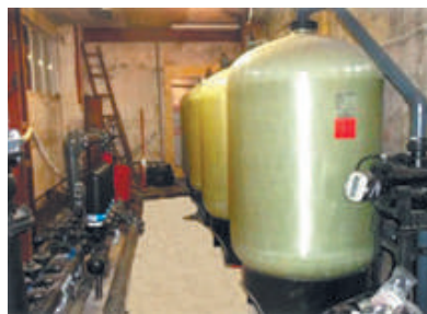
Станция обезжелезивания хозяйственно-питьевого назначения производи- тельностью 2800 м³/сутки
