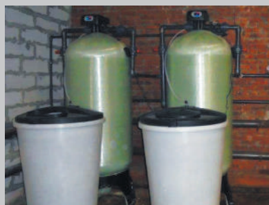
Станция умягчения воды непрерывного действия производительностью 10 м³/ч
